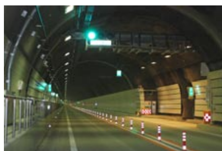
信号機が設置されたトンネル内部
