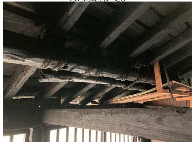
明かり窓庇屋根 屋内（新材は所有者 DIY による雨漏り対策）
