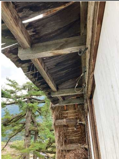
北側合掌妻面の窓庇の葺き板の劣化
