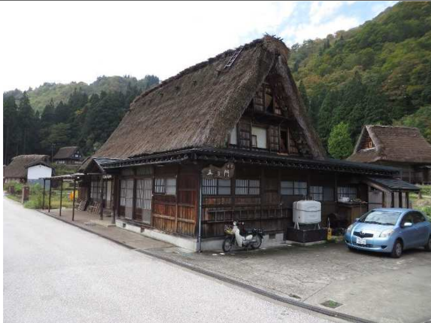
東側（道路側）の屋根は前回葺替えから22年経過（西側19年）
