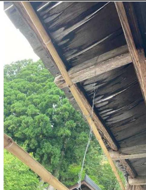
南側合掌妻面の窓庇の葺き板の劣化
