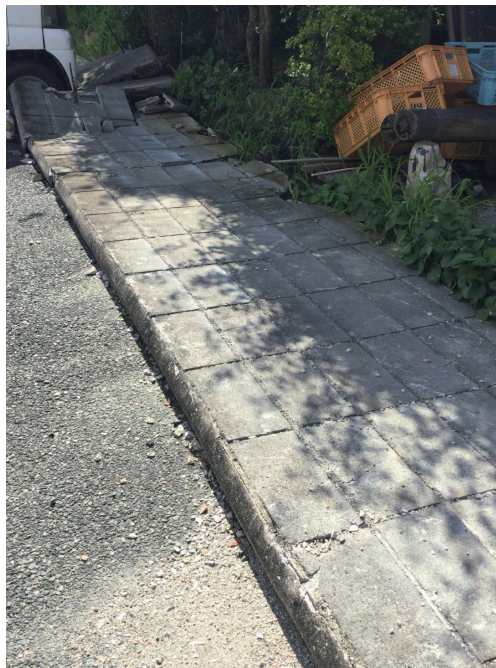
地震によりブロック塀が倒壊
