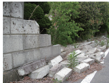
地震により石塀が倒壊
