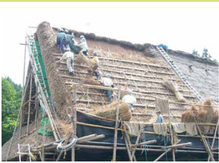
茅屋根の葺き替え作業 村の人たちが協力して茅を屋根に運び上げます。
