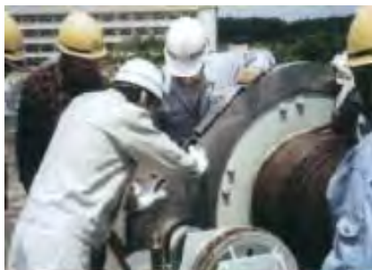
ポンプ点検状況
