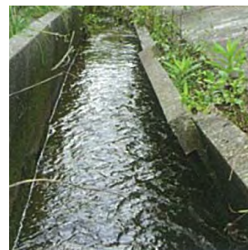
側壁の倒壊（側溝）
