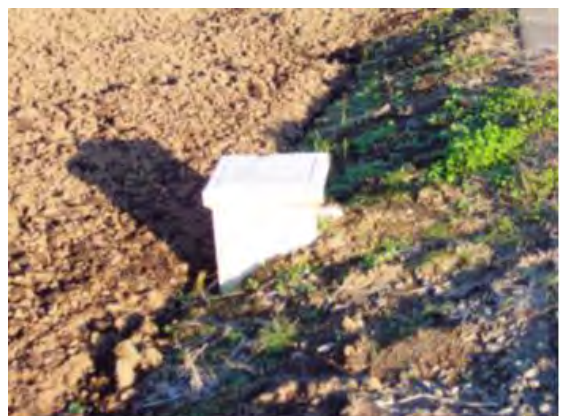
傾いた給水栓ボックス
