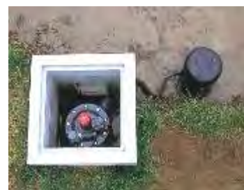
給水栓の自動化
