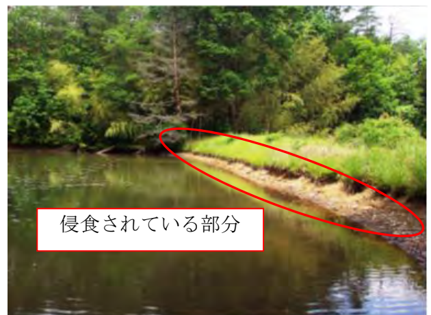
侵食が生じているため池堤体
