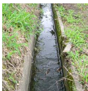
部分的な欠損
