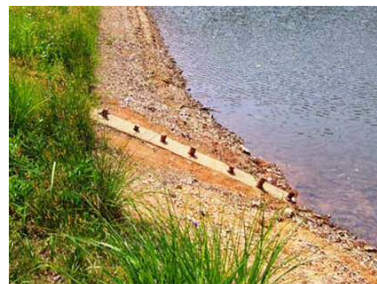
老朽化した取水施設
