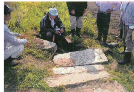
側溝蓋の損傷
