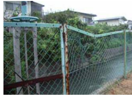
破損した金網フェンス
