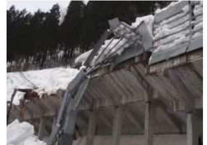
▲雪崩で被災した落雪防護柵
